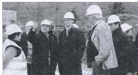
▲ Le 7 décembre dernier, Franck Riestler, député-maire de Coulommiers, Elisabeth Escuyer, maire de Mouroux, en compagnie d'élus columériens et mourousiens, se sont rendus sur le chantier de la future station d'épuration gérée par le Syndicat intercommunal à vocation unique (structure intercommunale entre Coulommiers et Mouroux).
